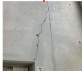
壁面ヒビ(本部棟)
