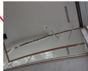
天井部材落下(本部棟)
