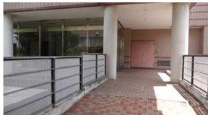
地面ズレ(体育館前渡り廊下)
