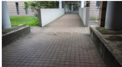
地面ズレ(1階渡り廊下)
