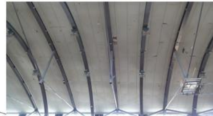
天井部材ズレ(体育館)
