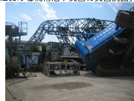
〔千葉県千葉市で発生したクレーン転倒災害の災害調査〕
