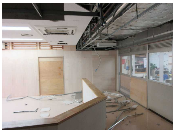
化粧板が全て剥がされたデイルームの壁
