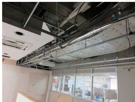
天板が全て剥がされた天井
