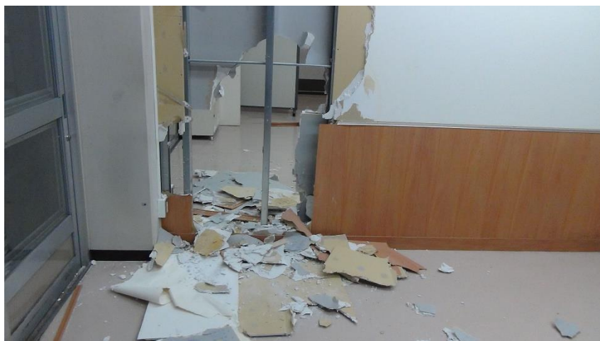
破壊され貫通した居室の壁
