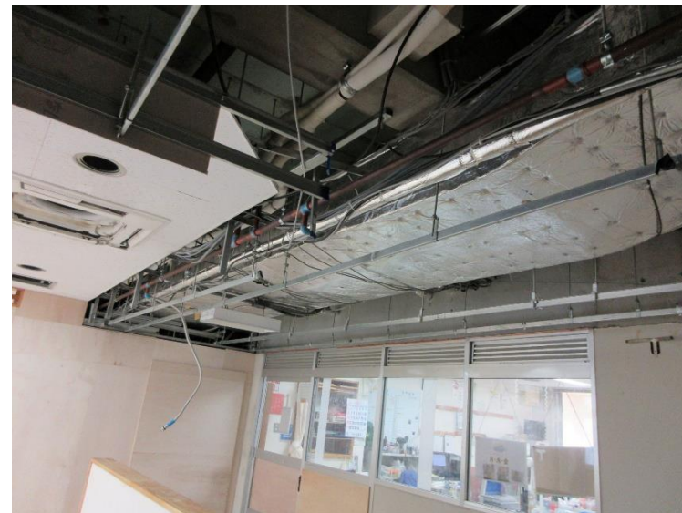
天板が全て剥がされた天井
