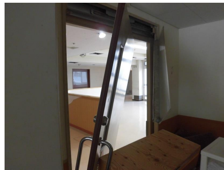
破壊されたりネン庫のドア
