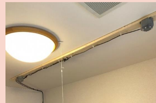
居室天井に設置したセンサー
