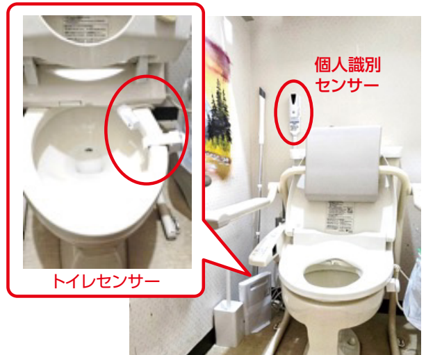
センサーの設置状況
