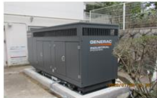
大型の自家発電機
