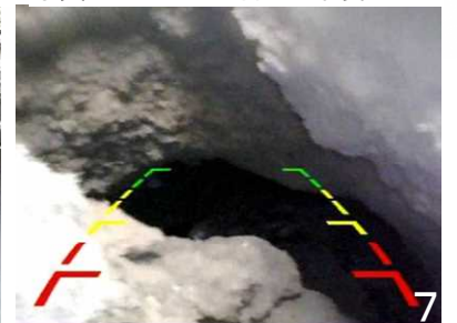
写真3 B1-19空洞状況深度2.9m
