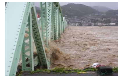
台風12号による被害
