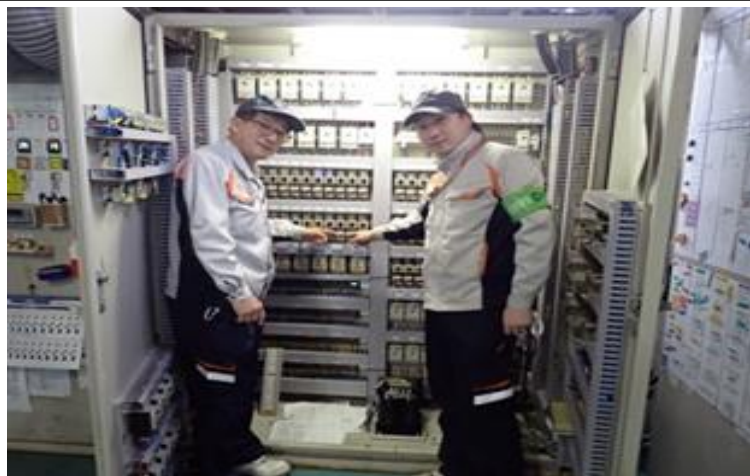
〔制御盤で製造課へ診断にて不具合箇所の説明〕
