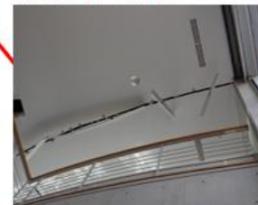
天井部材落下（本部棟）
