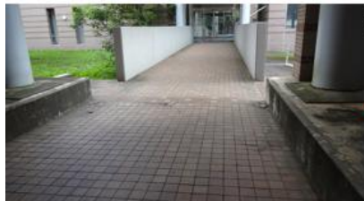
地面ズレ (1階渡り廊下)
