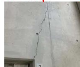
壁面ヒビ (本部棟)
