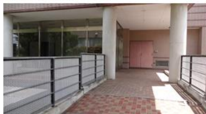
地面ズレ (体育館前渡り廊下)
