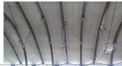
天井部材ズレ (体育館)
