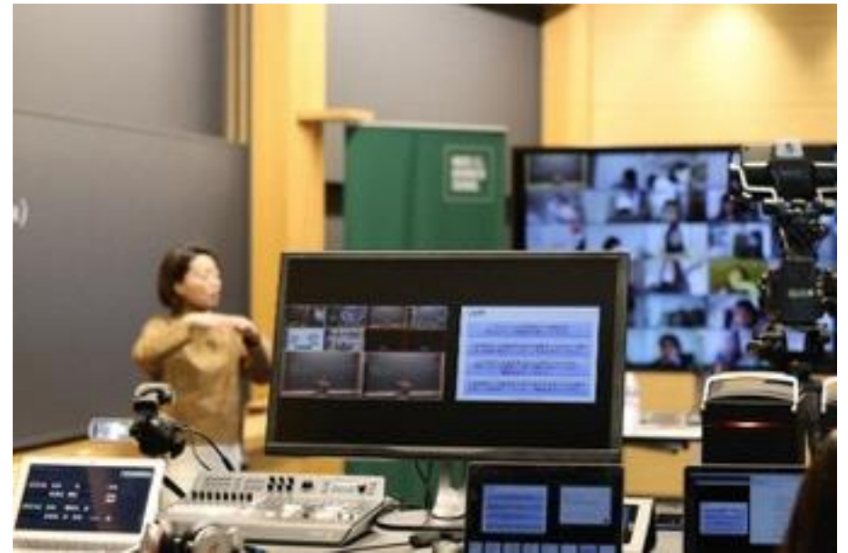
同時双方向でのライブ議論を行うための設備
