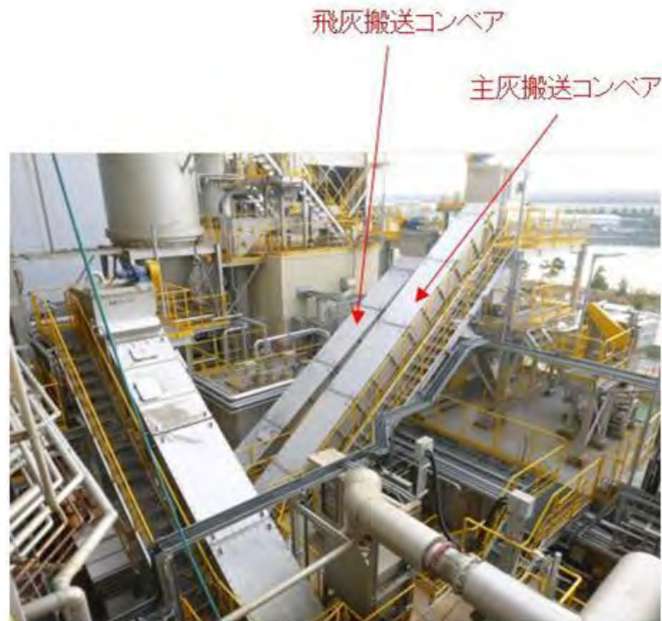
主灰搬送コンベア、飛灰搬送コンベア
