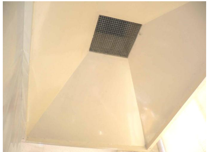
フード内天井部分の排気口 (0.35m×0.35m)
