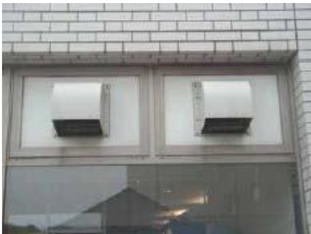
換気扇屋外側
