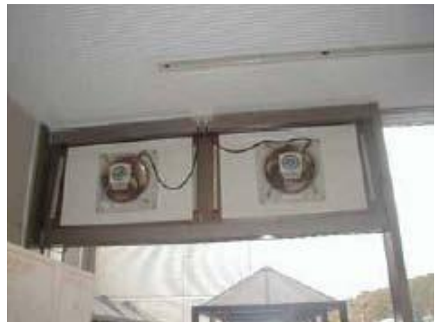
換気扇屋内側
