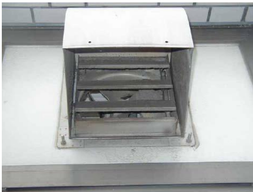
換気扇メンテナンス前 風圧であがるはずのシャッターが半開き状態
