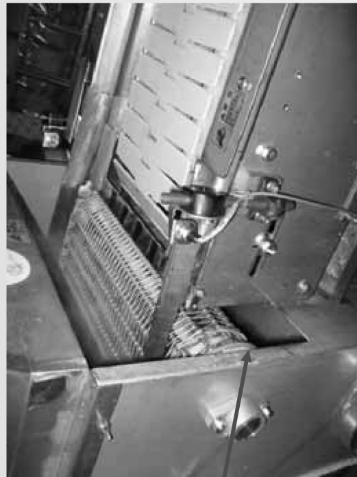
ネットコンベア入口 出口
