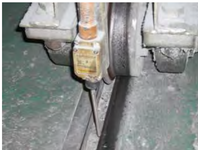
写真 2 トラバース (台車) のリミッター
