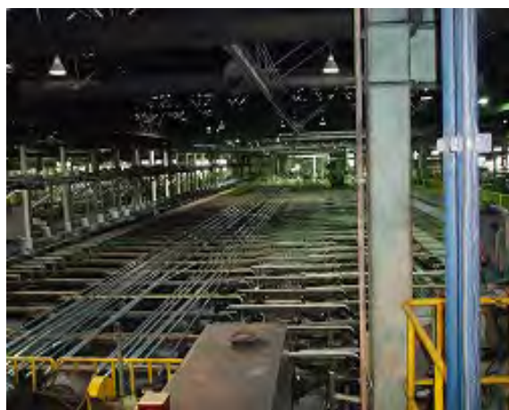
④後面設備（後面設備全体）
