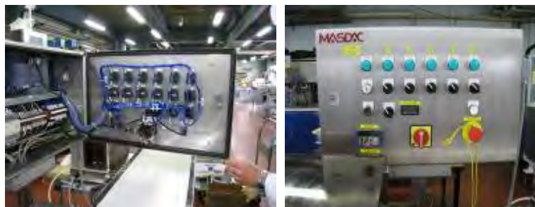
図 14. 操作盤扉の電氣的危険源
