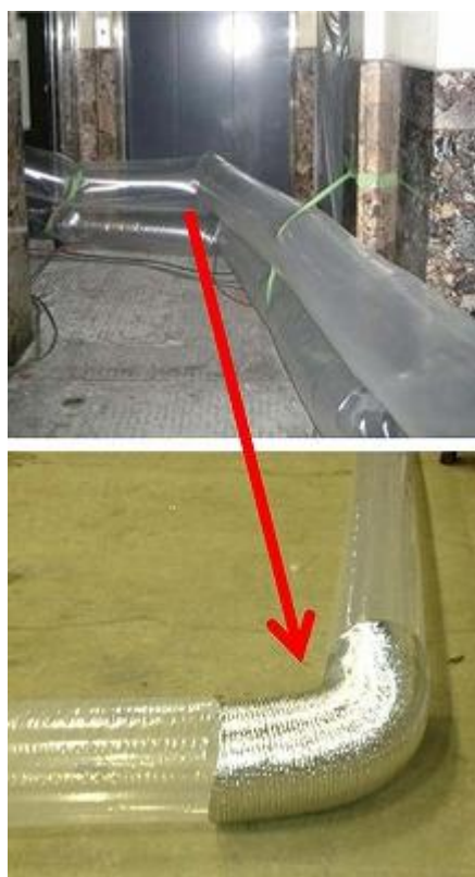
図－９ ビニールダクトの曲がり部分に環状の支え（アルミ製ダクト）をビニールダクトに重ねて使用した例
