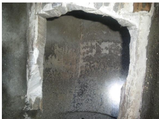
写真Ⅱ－9 ハイスタック煙突断熱材
