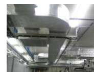
ダクトの写真
