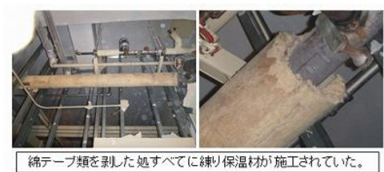
写真Ⅱ－15 直管部分にも使われる配管保温材
