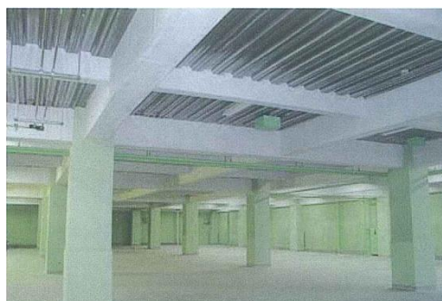
写真Ⅱ－20 けい酸カルシウム板第二種を耐火被覆として使用している例 (この施工例は石綿無含有製品)
