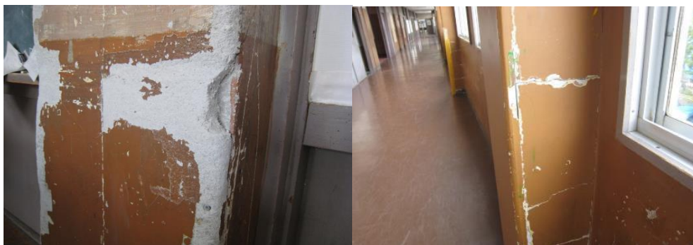
写真Ⅱ－21 鉄骨造校舎 教室・廊下の柱 長年の接触により欠損している
