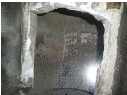
写真Ⅱ－10 ハイスタック煙突断熱材
