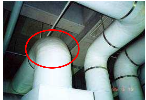
保温材（配管等）
