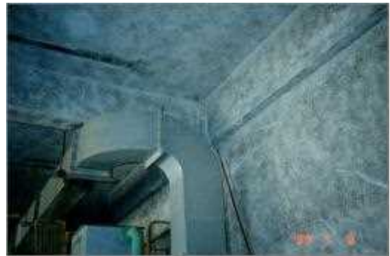
機械室の壁・天井の断熱
