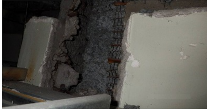
写真Ⅱ－13 壁の中に青石綿が吹かれラス網の上モルタル＋プラスター塗り仕上げ
