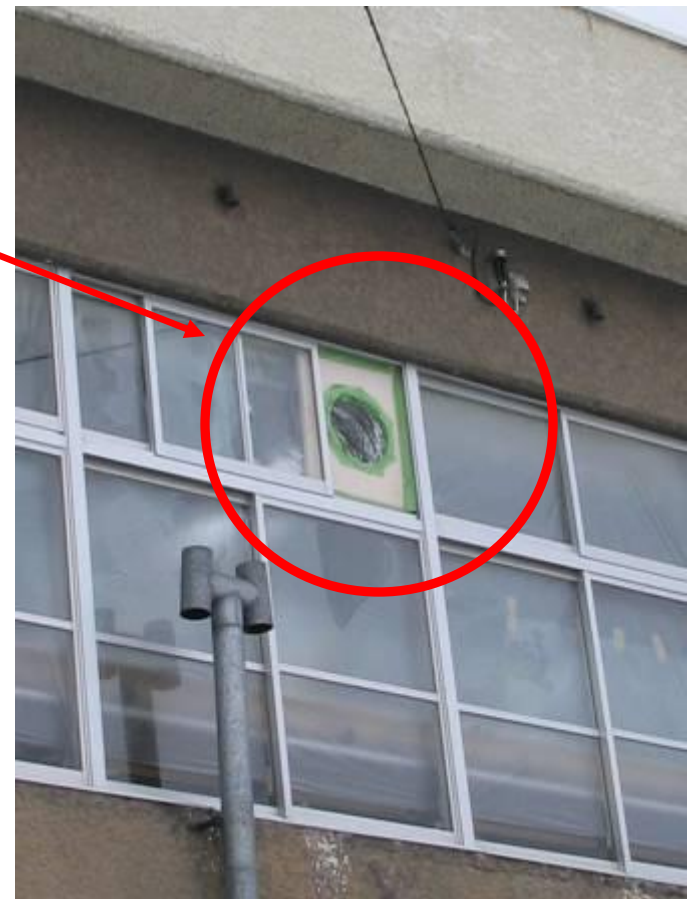
小学校教室外の排気口
