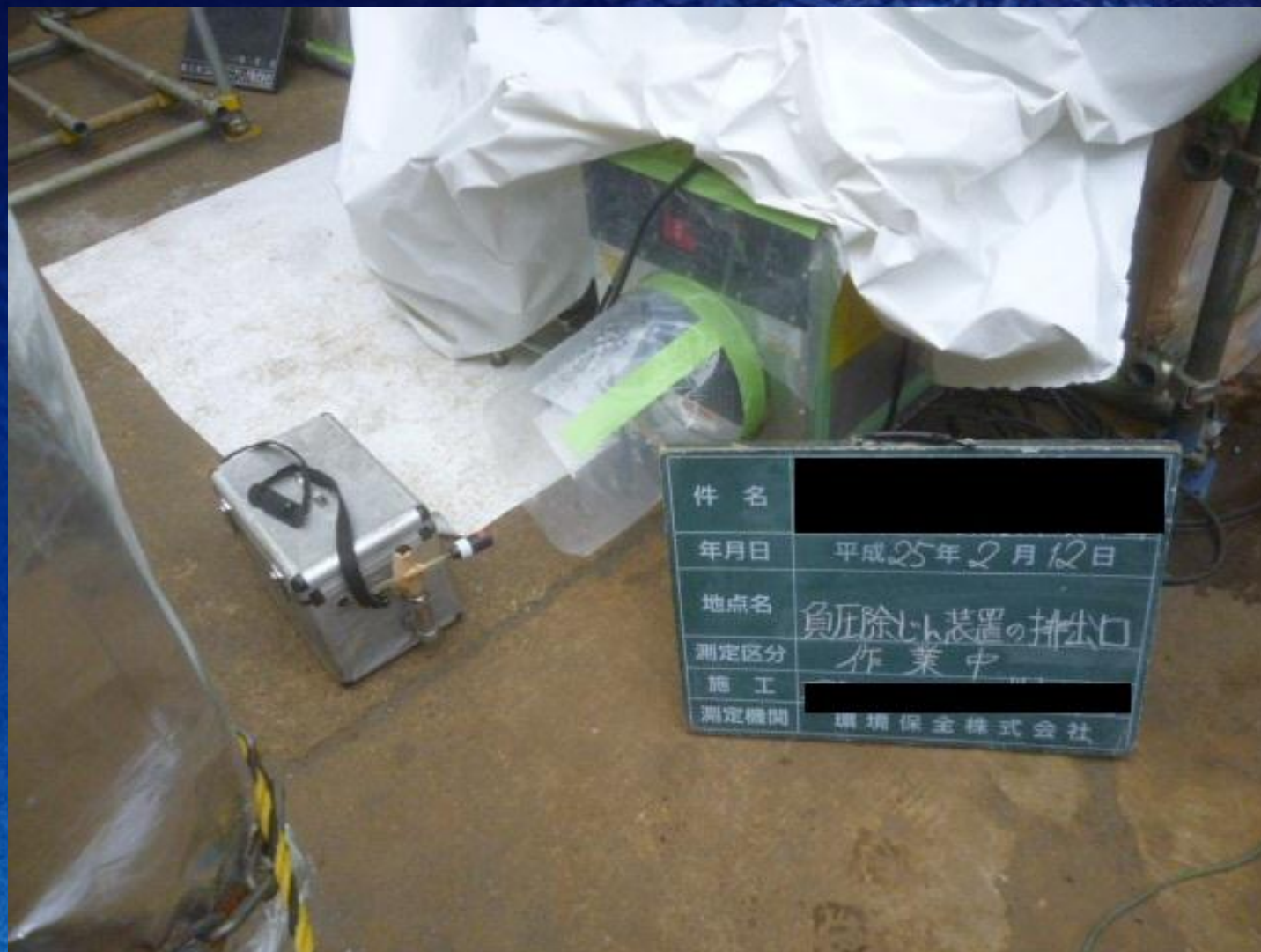
負圧除じん装置排気口(2時間測定)
