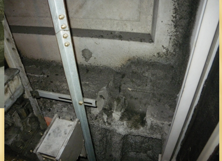
ELVシャフト内
