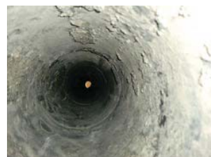
写真Ⅱ-11 ライナー付きカボスタック 煙突断熱材
