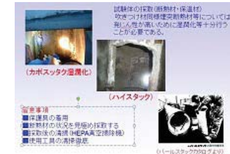
図-3 サンプリング例(煙突断熱材)
