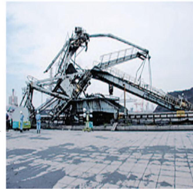
クレーンの崩落災害
