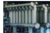
インライン浄水処理
