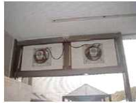
換気扇屋内側
