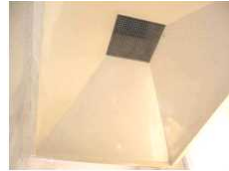
フード内天井部分の排気口 (0.35m × 0.35m)
