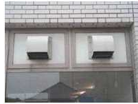
換気扇屋外側
