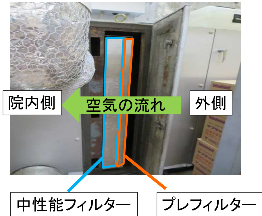
外調機のフィルター
