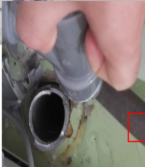
破断した透析配管配水
