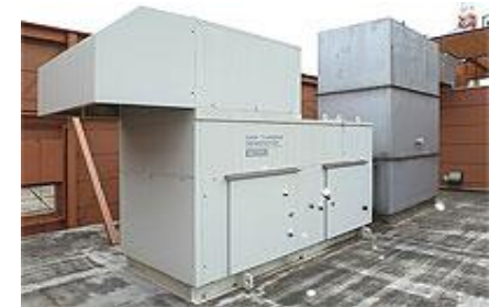
(非常用自家発電装置)
