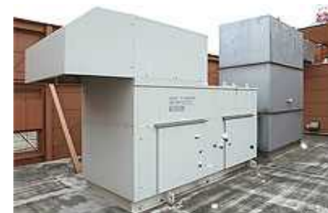
(非常用自家発電装置)
