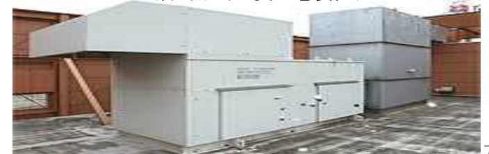
（非常用自家発電装置）
