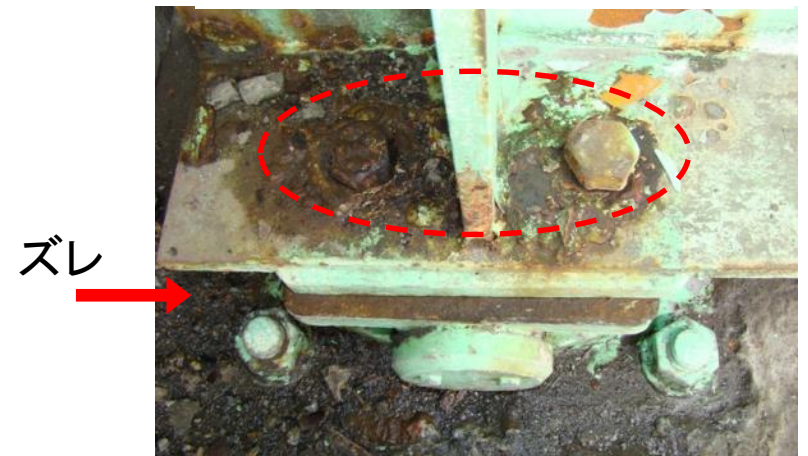
ボルトの破断(震災後)
