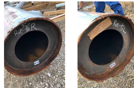
上弦材の破断(工場溶接箇所)
