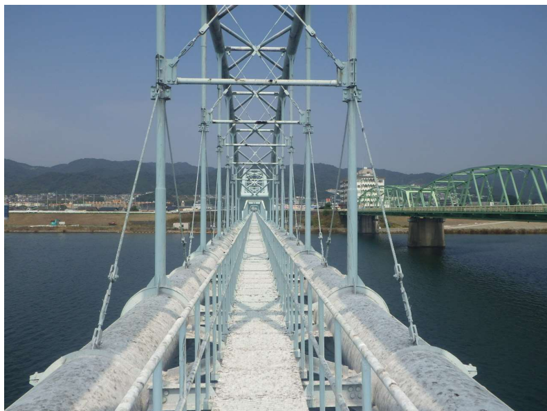
平成27年時 P4-P5径間 (落橋部)
