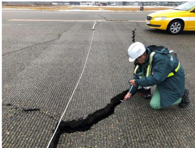
図 1-19 のと里山空港の被害状況
