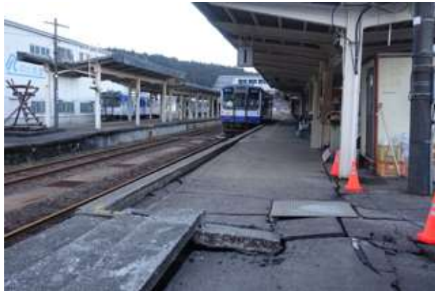
図 1-18 のと鉄道 穴水駅の被害状況
