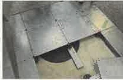
能登空港ビルの雨水利用施設
