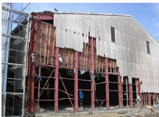
破損、落下したスレート波板
