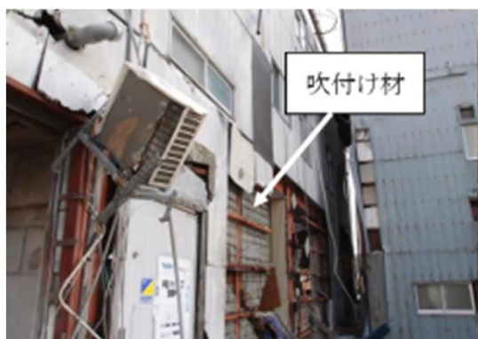
吹付け材が露出している例
