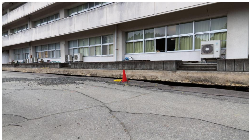
写真 飯田小学校の被害状況
