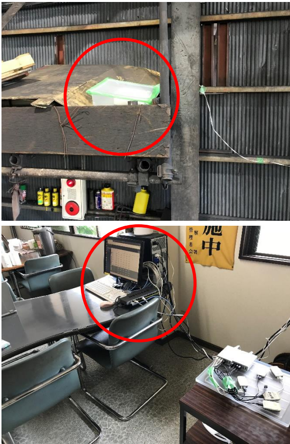
図3 計測システムの一部の例（上：BLE ルータ設置，下：管理用 PC）
