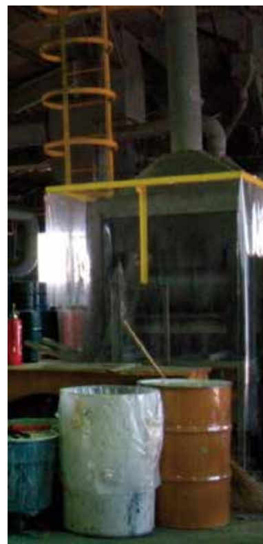
図 3-2c : 出口のビニールカーテン
