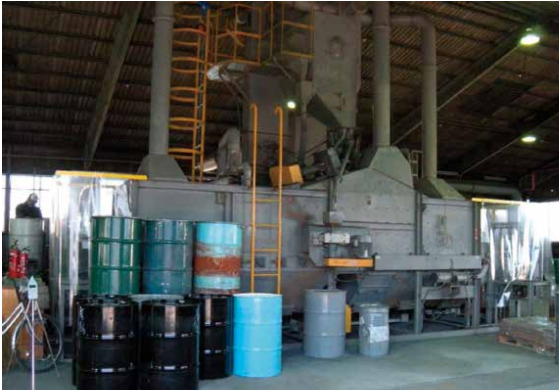
図 3-2a : ショットブラスト出入口にビニール製カーテンを設けたところ、周囲の騒音が低減
