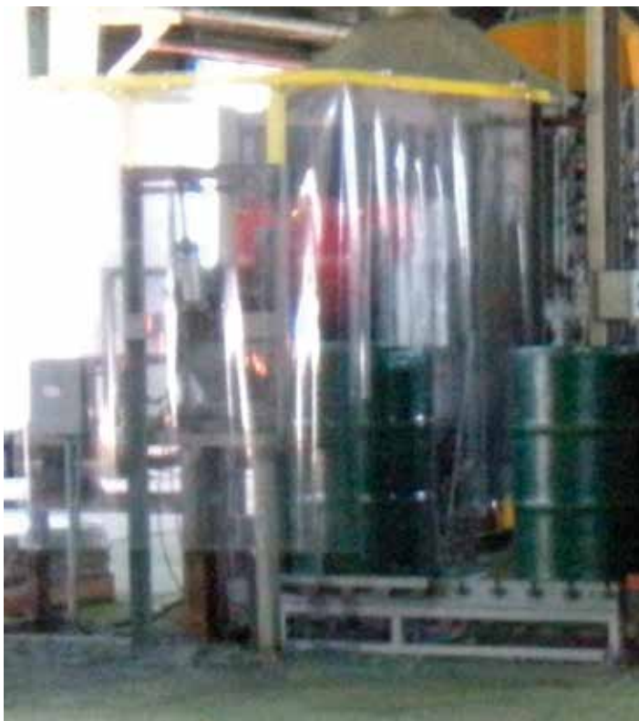
図 3-2b : 入口のビニールカーテン
