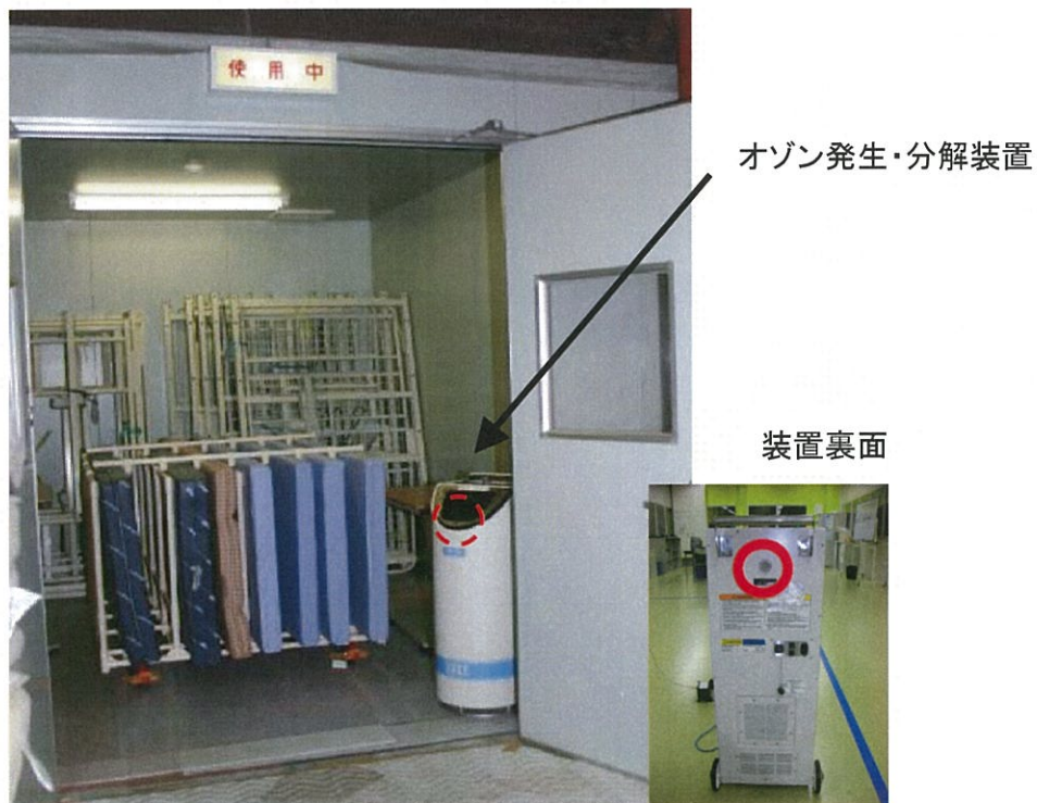
オゾンセンサー取付位置 : 床上約0.8m
