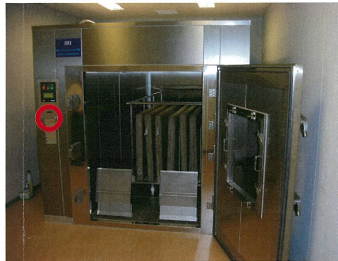
オゾンセンサー取付位置 : 床上約1m、扉の横
