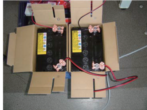
磁気ループアンプ用電源バッテリー（12V×2 台）
