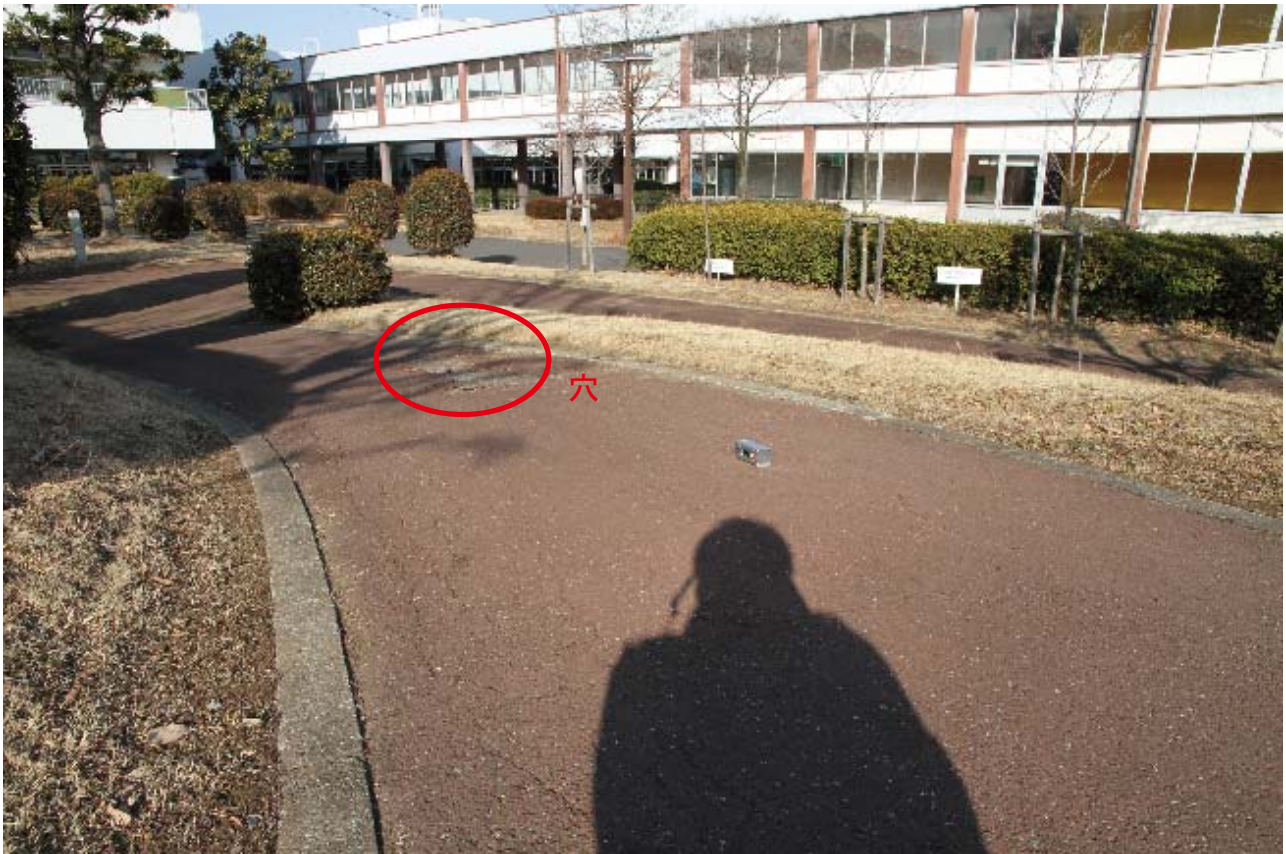
30 下り坂 最大傾斜 5.2°、右側に大きな陥没(陥没部は避けて通る)
