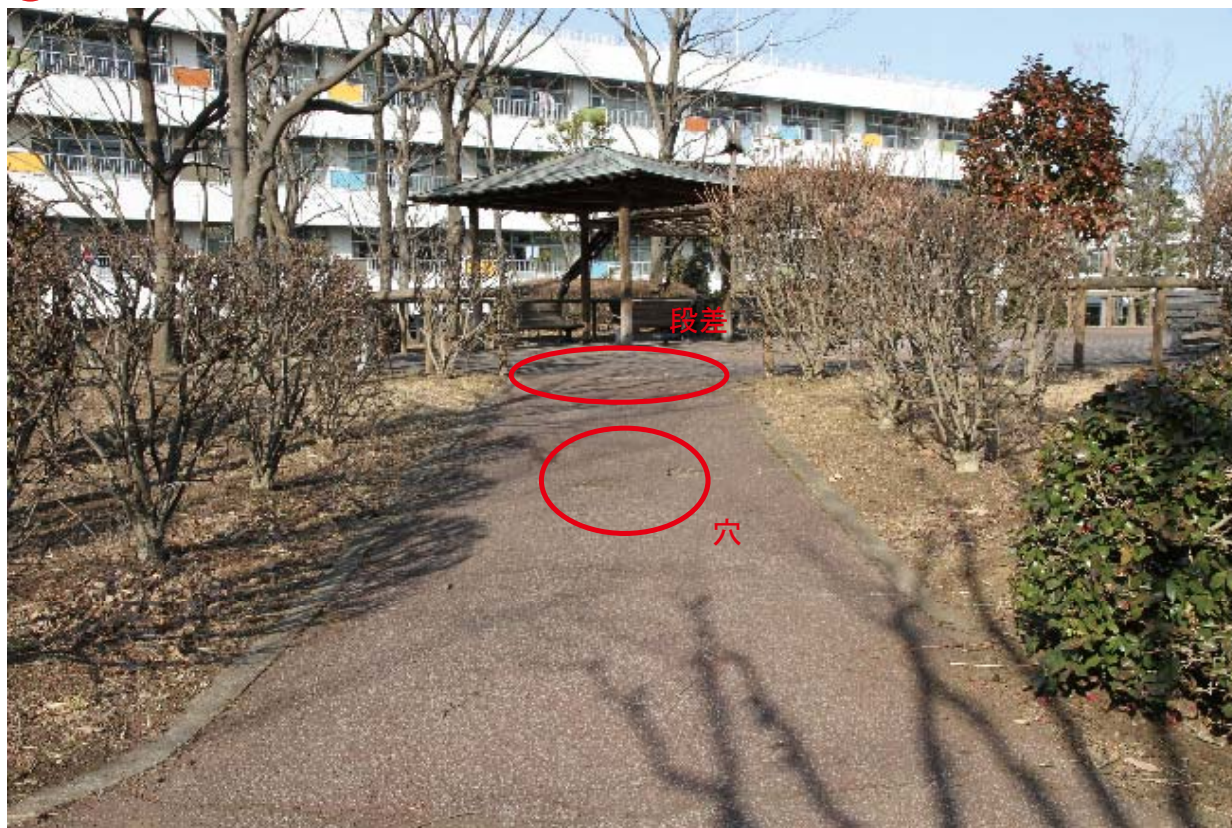
②⑦ 上り坂 最大傾斜 10.0^{\circ} 、歩道の穴 深さ 2.0~2.5cm、平地への移行部の段差 2.5 ~ 3.5cm
