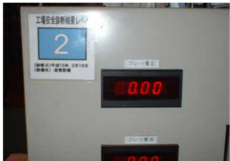
安全診断結果が レベル2であることを 示す銘板が貼ってある
