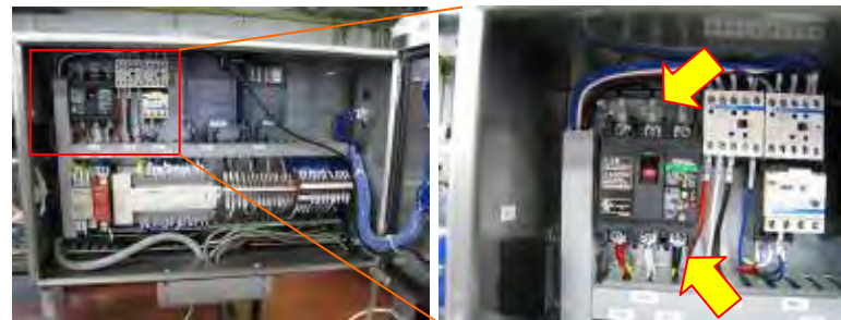
図 13. 操作盤内の電氣的危険源
