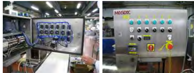
図 14. 操作盤扉の電氣的危険源
