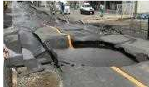
大阪府北部を震源とする地震における送水管の破損現場
