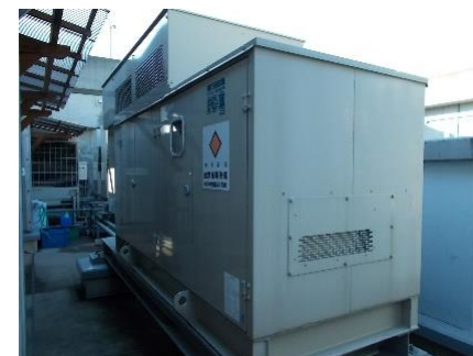
(非常用自家発電装置)
